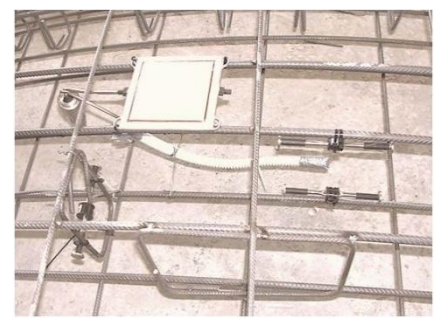
Instalación superficial del extensómetro de cuerda vibrante en el forjado antes del hormigonado.
