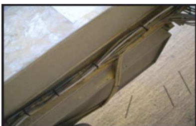
TUBOS DE AIRE UNIDOS CON BRIDAS PARA SU PROTECCIÓN
