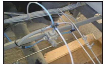
T CONECTADAS CON LOS TUBOS DE AIRE DE LA V. NIVELADORA
