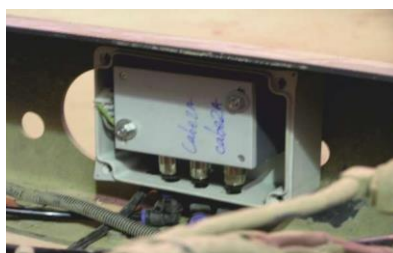
CONEXIÓN TUBOS DE AIRE
